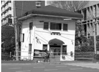
公益施設の傾斜
