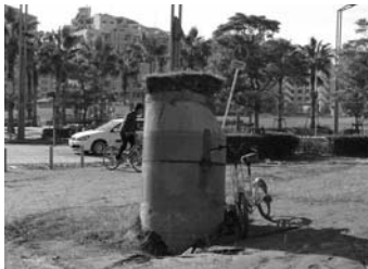
浮上したマンホール
