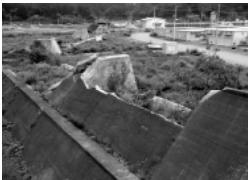
08 津波で破壊された田老地区堤防と付近の仮設住宅(宮古市)
