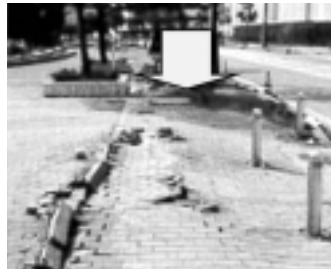
地表の変形 海浜幕張駅付近
