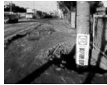
地盤(電柱)の沈み込み 美浜区新港地区
