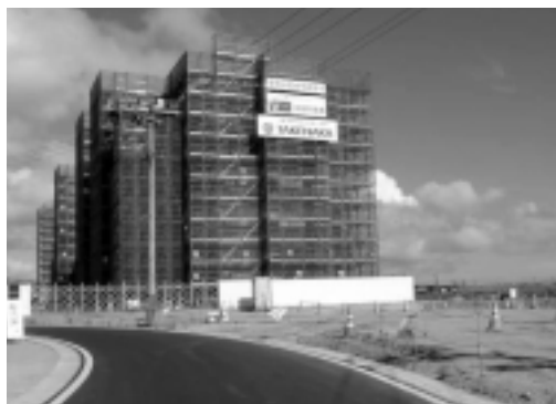
石巻市門脇地区の盛土嵩上地に建設中の復興公営（UR）集合住宅。(2016年8月撮影)
