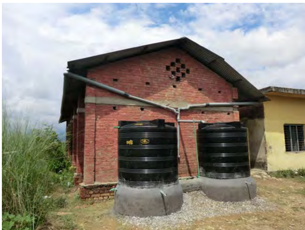
写真 6.1.1 バルプリー小学校の校舎に設置された雨水利用実験装置
