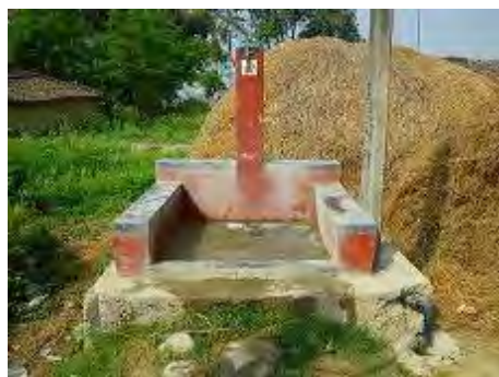
写真 5.3.2 水道施設（ゴイニ）写真 5.1 の給水塔より配水される共同水場。利用 料金 70 ルピー/月、給水は 1 日約 2 時間
