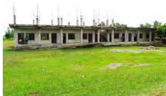
完成したコカプルワの高校. 階上支柱鉄筋がむき出し, 2階を増築するものと思われる。
