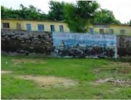
ピパラ Pipara 南部の小学校 ↑ 小学校の外壁面に描かれたヒ素被害の 周知活動壁絵。色が落ちてカビが生えて 内容がわからない（2014年8月）
