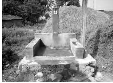
写真 2 水道施設(ゴイニ) 写真 1 の給水塔より給水される共同水場
