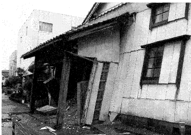
8. 東本町の寺福巖院. 基礎部分から傾いている. 側壁の土壁は傾いて剥がれむき出しとなっている。
