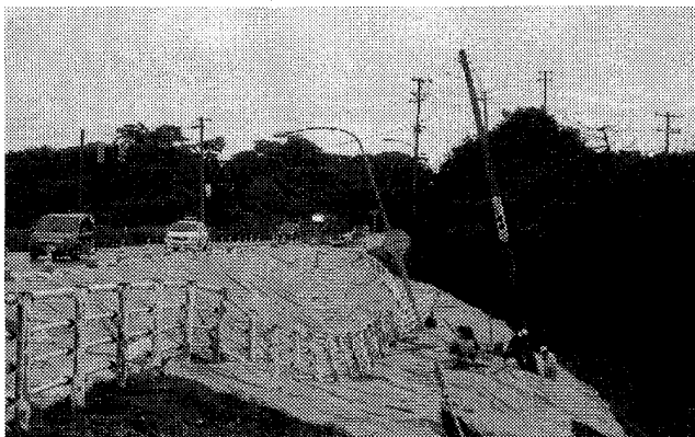
3. 国道8号線鯨波付近。路肩部分が崩れ、ブルーシートが被せられている。
