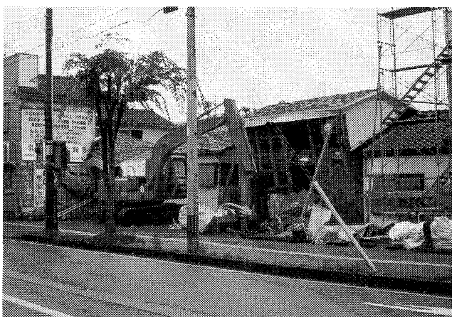
10. 東本町二丁目. 壊れた家屋. 傾いた家は解体が始まっているところもみられる。
