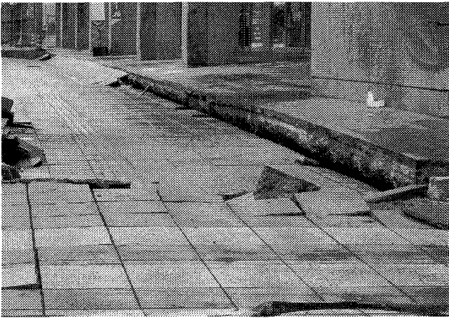
31. 東本町モーリエ2ビル（5階建）前30cmの段差.
