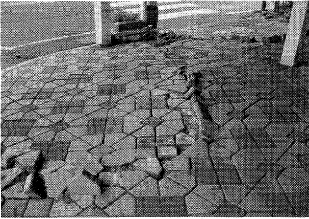
29. 西本町交差点 Wの字に亀裂.
