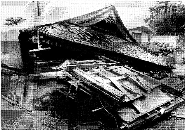
25. 柏崎神社の神楽殿. 柱・壁が折れ完全に潰れた状態.
