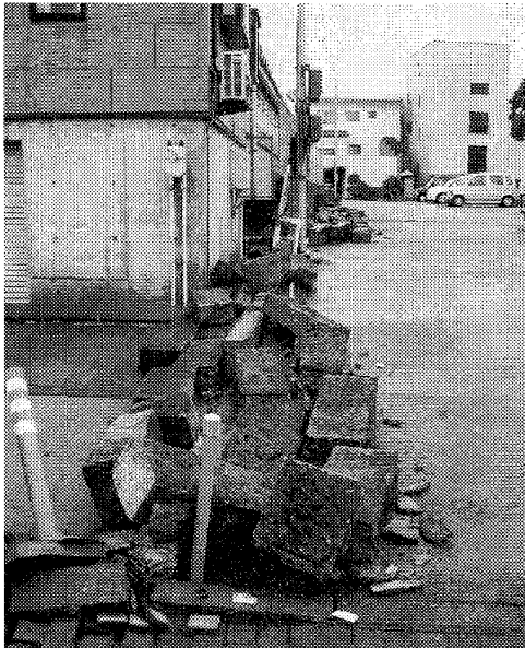
13. 東本町、ブロック石塀（自然石）が倒れている。こうした箇所は多い。
