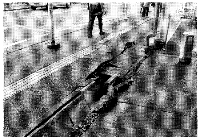
28. 西本町. 側溝が落ち込んでいる.
