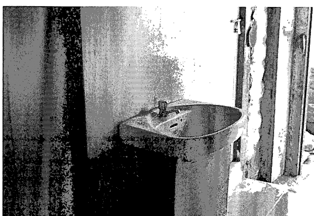
No. 6 コンデロッジの水道 もっぱら洗顔用で、飲料水にはいけない。
